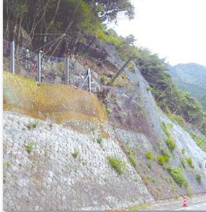
ロープ足場設置後 丁張をかけ、現地起工測量を行い、部材を製作する。
